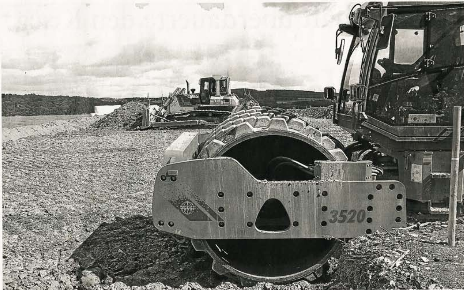
Der Untergrund des erweiterten Firmengeländes wird auf einer Fläche von 20 000 Quadratmetern planiert. Acht neue Hallen werden hier entstehen.
